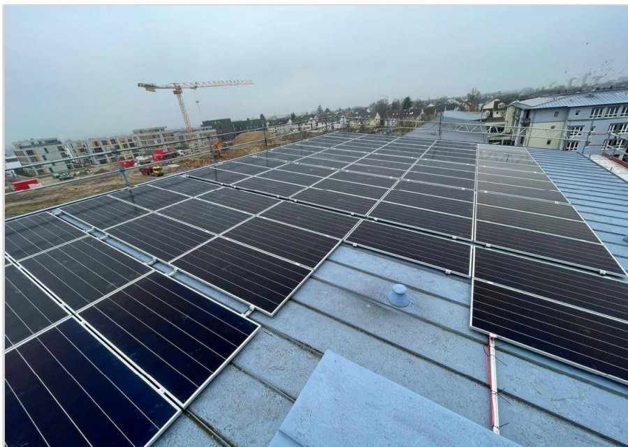
PV-Anlage auf dem Rathaus Mitte
